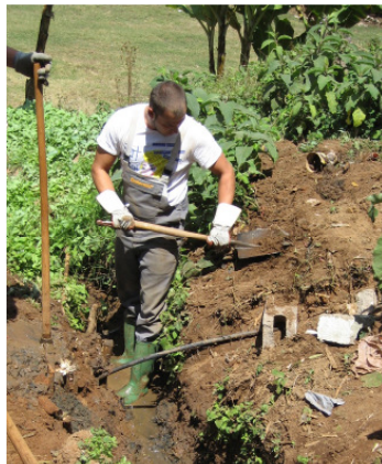
Die Zapfstelle muss dringend repariert werden
