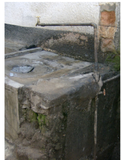
Die Zapfstelle muss dringend repariert werden
