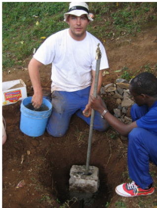
Die Zapfstelle muss dringend repariert werden
