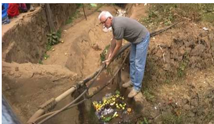
Die alte Wasserleitung über die Brücke - Wie lange hält die wohl noch?
