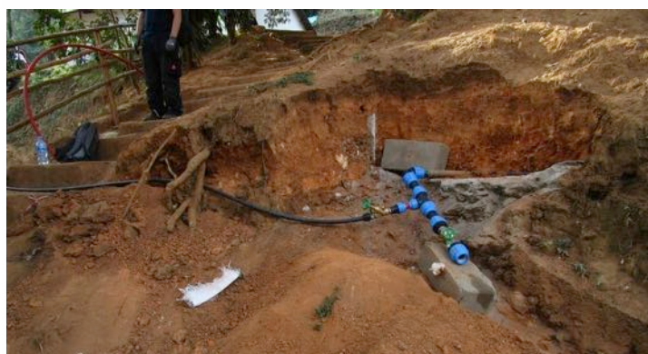
Der Trinkwasserverteiler ist fertiggestellt
