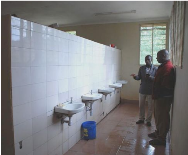
Die Armaturen und Abläufe müssen repariert werden
