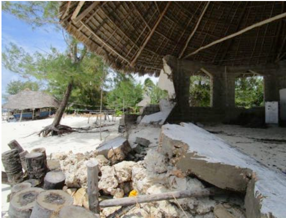
Klimawandel: Ein unterspültes Haus am Strand als Folge des steigenden Meeresspiegels.
