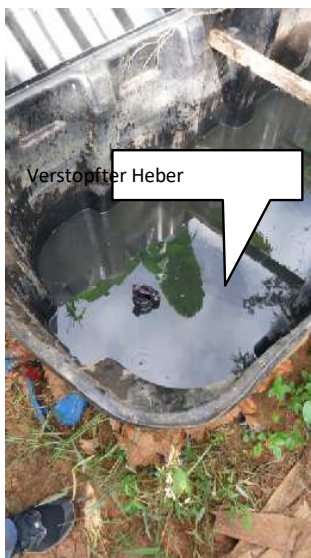
Zustand des Vorfluters.
