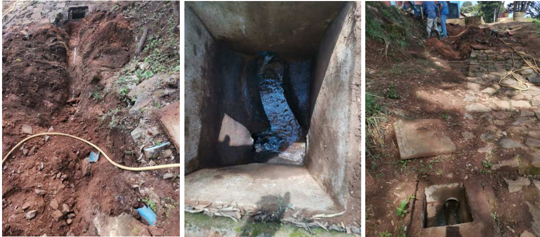
Freispülen der verstopften Abwasserleitung von den Toiletten
