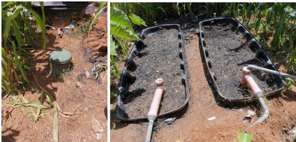
Verteiler und Klärbehälter von der Einlaufseite aus.
