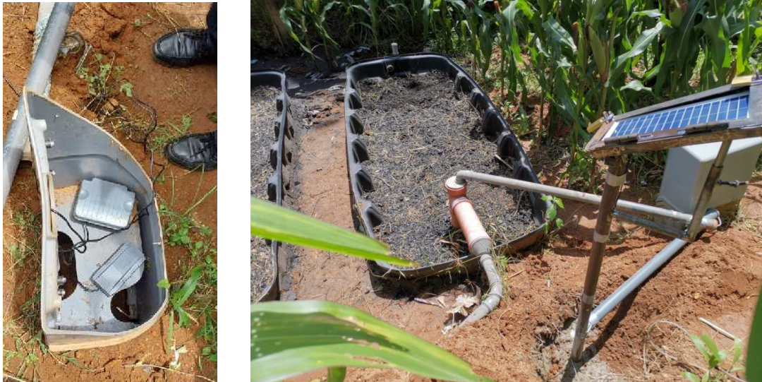
Abschließbares Pumpengehäuse und gesicherter Metallrahmen für das Solarpanel
